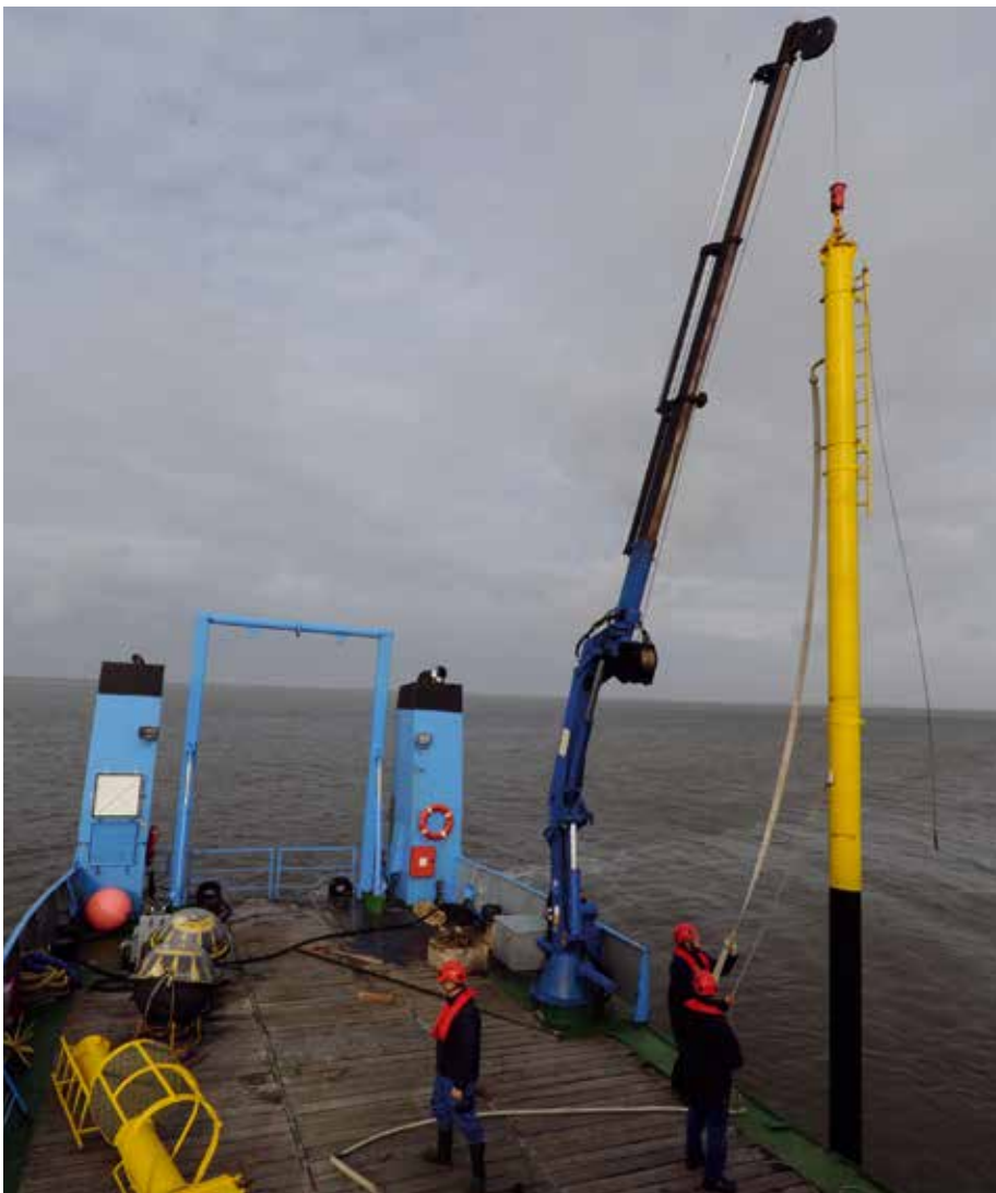
Liefern wertvolle Erkenntnisse mit Blick auf den Klimawandel: Die Messpegel des NLWKN, von denen hier gerade einer gesetzt wird.
