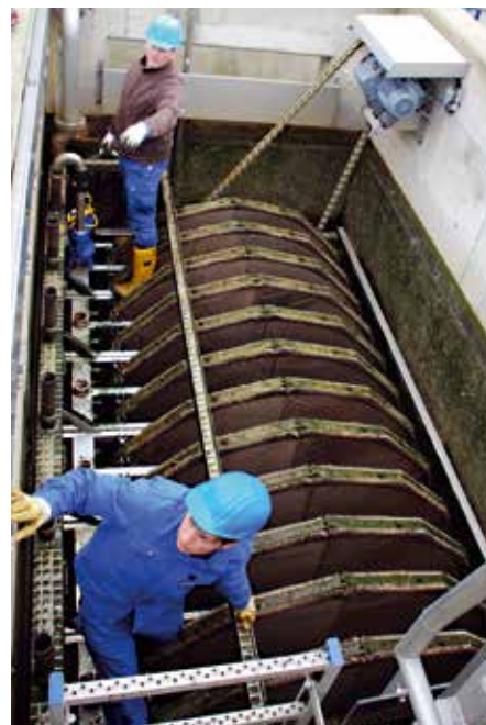
Die Schlussfiltration der Kläranlage in Oldenburg: Nach einer vom NLWN gemeinsam mit dem OOVV in Auftrag gegebenen Studie haben die Scheibenfilter Potenzial Mikroplastik zumindest teilweise zurückzuhalten.
