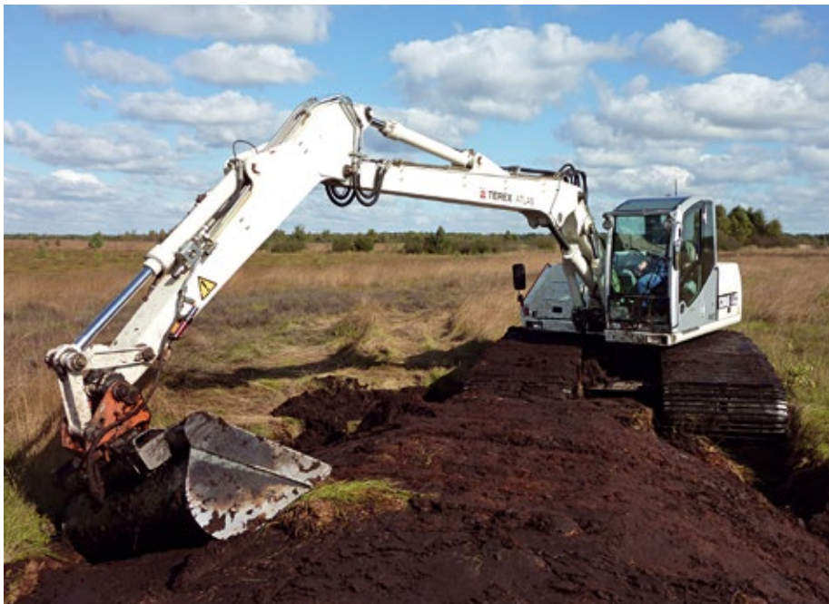
Vor dem Kranich kommt der Bagger: Hier wird ein Damm zur Wasserrückhaltung im Neustädter Moor angelegt – so wird ein Schlafplatz für die Kraniche gesichert.
