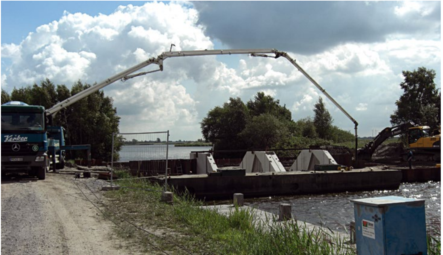
Ein Stauwehr am Großen Meer in Ostfriesland: Wasserwirtschaft und Naturschutz haben Hand in Hand gearbeitet.
