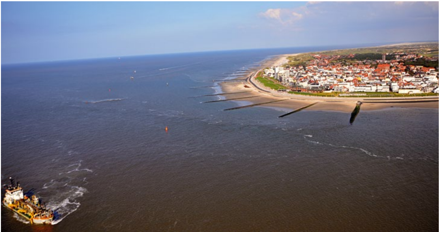
Aufspülung des Strandes auf Norderney: Der Hopperbagger „Elbe“ saugt sich mit Sand voll, der dann mit kleinen Umwegen als Sand-Wasser-Gemisch direkt am Strand landet. 250.000 Kubikmeter Sand wurden aufgespült.
