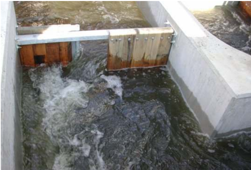
Strömungsöffnung in der Fischtreppe
