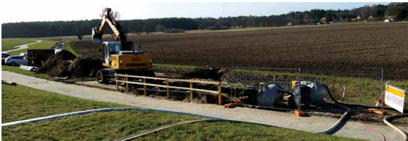
Es soll die Gefahr rückstauenden Wassers nachhaltig bannen: Kleinschöpfwerk bei Preten.
