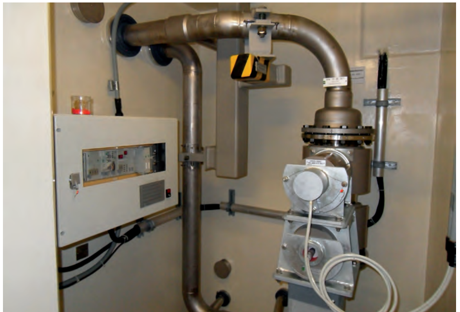
Kernkraftwerk Emsland: Radioaktivitätsmessgerät.
