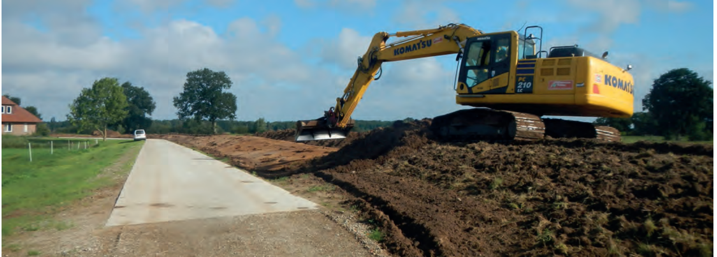
Verstärkung der Deiche bei Hülsen an der Unteraller: Die wichtigen Deichverteidigungswege werden an das Verkehrsnetz angeschlossen.
