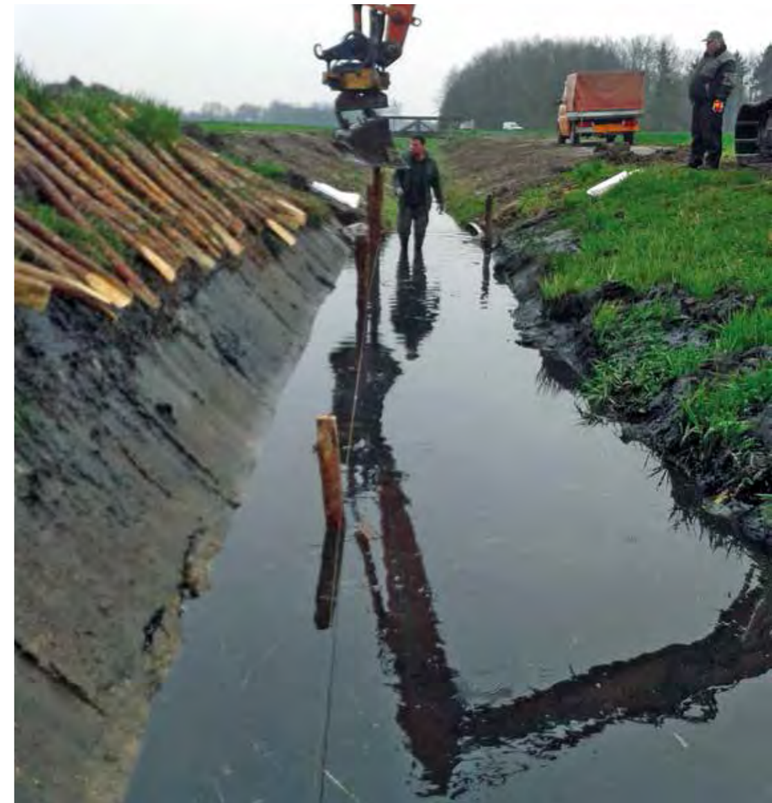
▲ Grundsanie rung Ufer nach Nutriabefall Foto: Godehard Hennies
